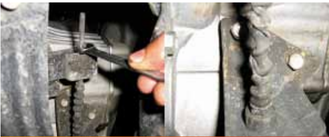
Figura 3. Procedimiento incorrecto: Ajustar la tuerca con el sistema precargado. Esto origina el entorchamiento del cable y su posterior rotura.
