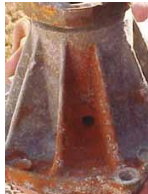
Imagen 4. Bomba de agua con oxidación
